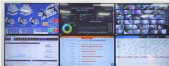
中央監視室によるリモートモニタリング
