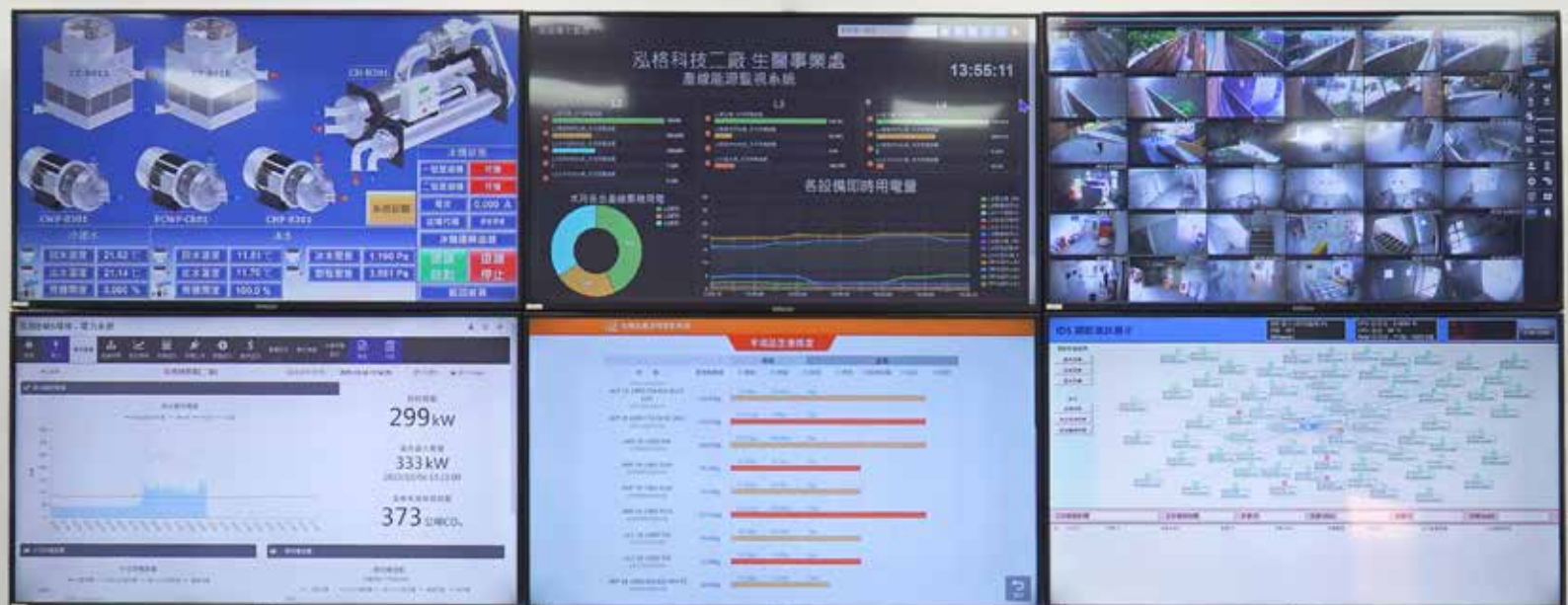
中央制御室による遠隔監視
