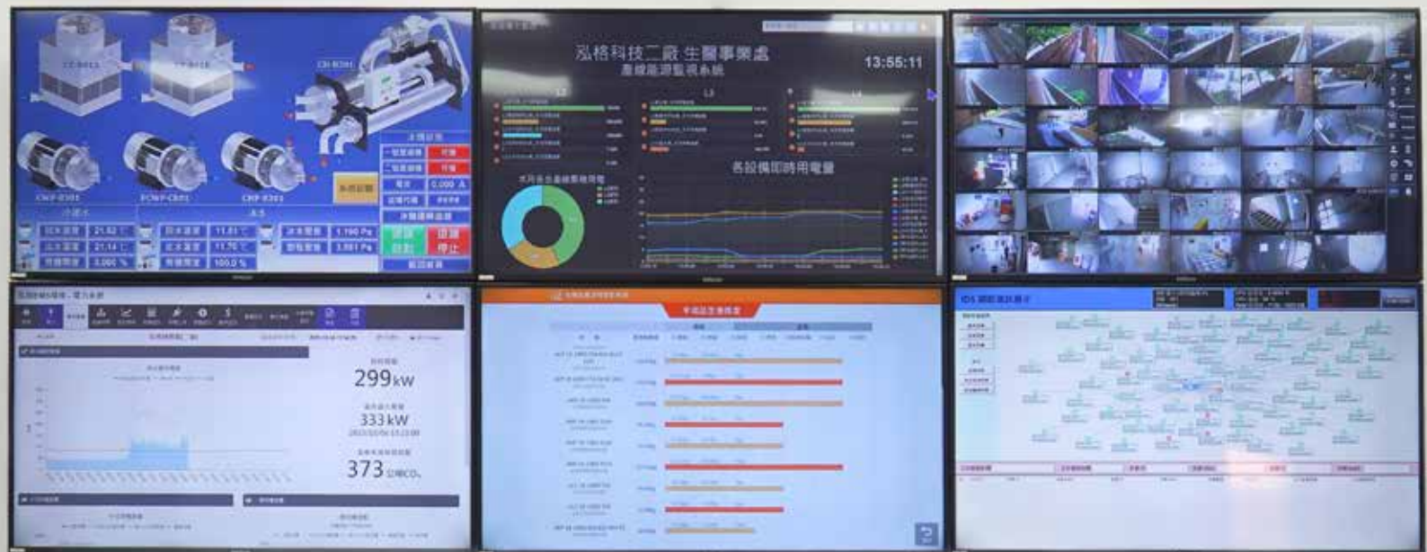
中控室远端监控
