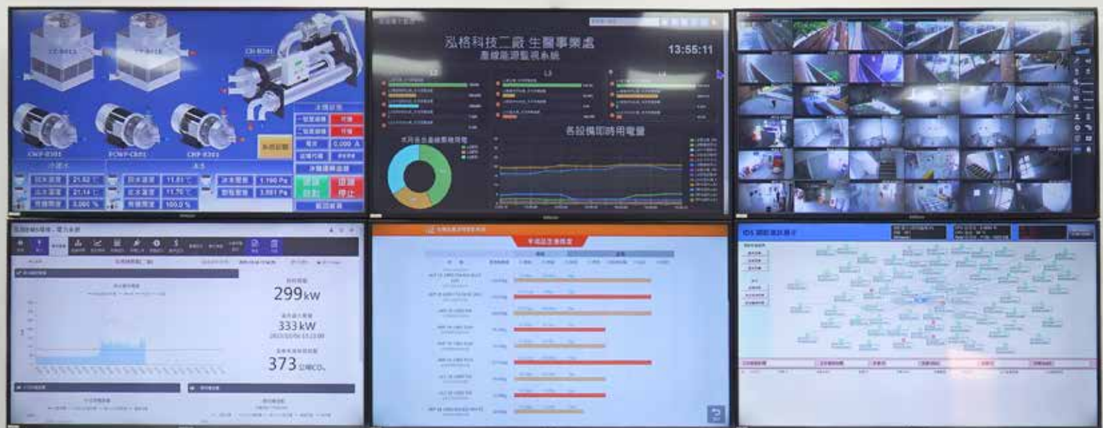
中央制御室による遠隔監視
